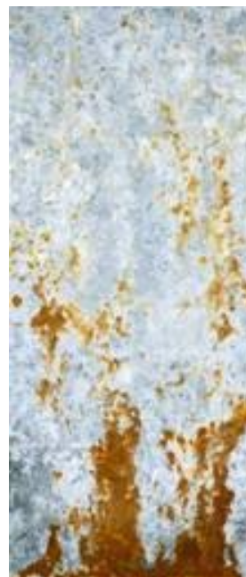
Aluzinc® через 34 недели
